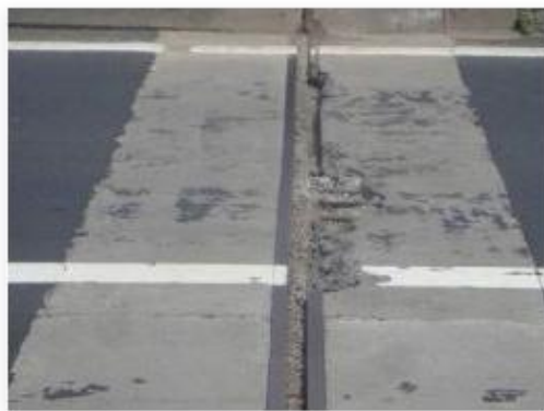
图 3-8 (d) 伸缩缝混凝土破损
