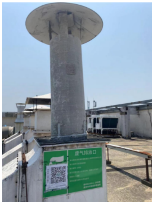
图 2-7 现有项目排气筒现场照片
