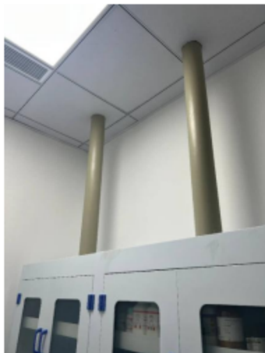
药品柜废气管道收集
