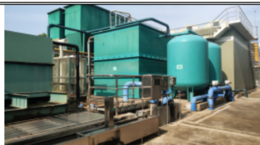
污水处理设施
