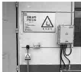
危废仓库外部标识牌
