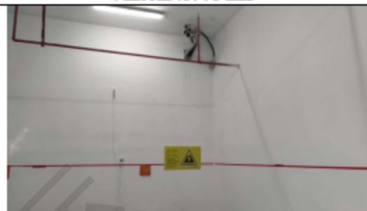
危废库内部监控
