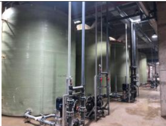
废水中转储罐
