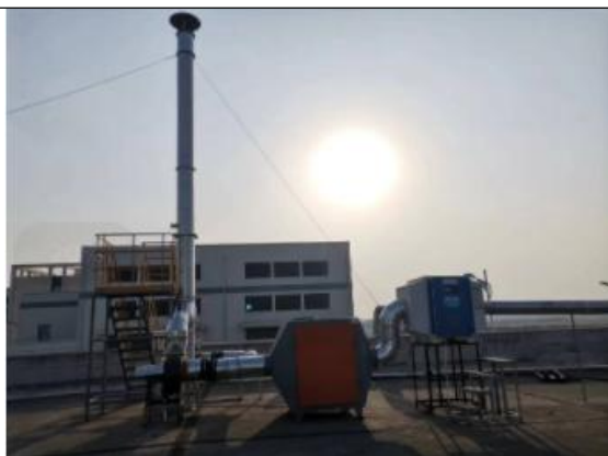
二级活性炭+FQ-9 排气筒
