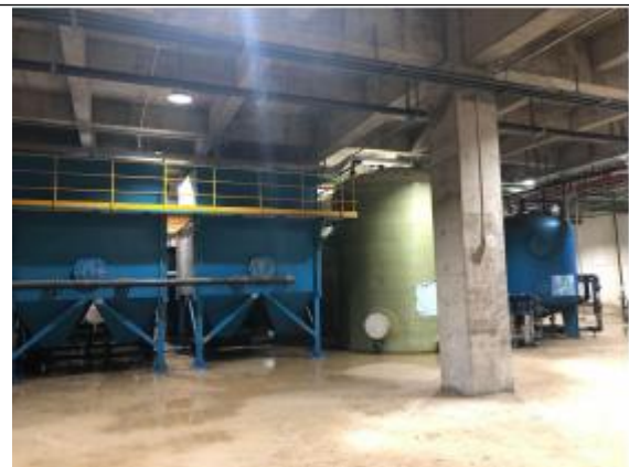
综合废水处理系统
