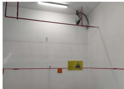
危废库内部监控
