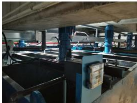
废水处理系统中所含的芬顿处理系统
