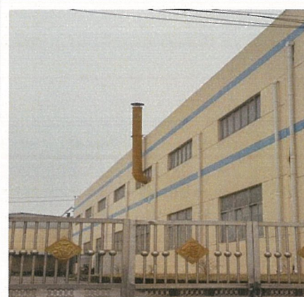
废气排口（DA001）
