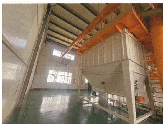
布袋除尘措施
