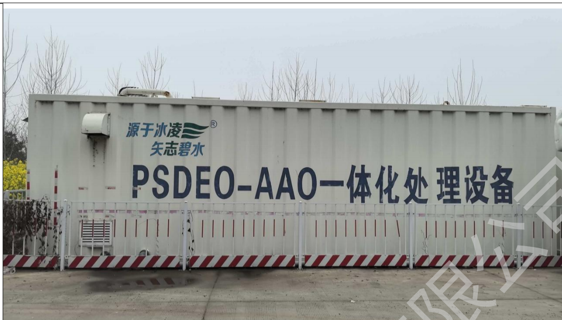
图4-6中南智谷产业园附近的六合区雄州街道工业园自建污水处理站现场图 废水水质可行性分析
