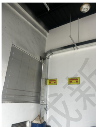
危废仓库内部视频监控设备
