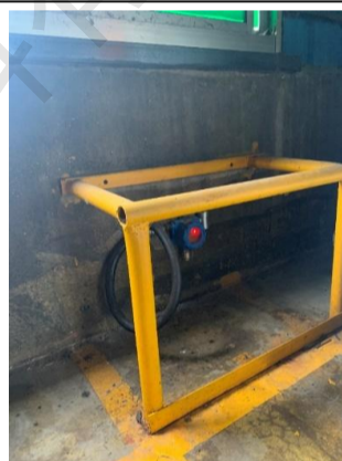
危废仓库内部可燃气体报警设备
