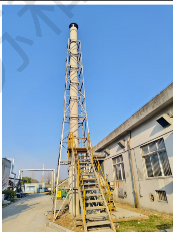
危废仓库配套的废气治理设施
