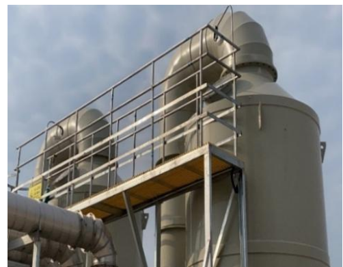
排气工段废气收集现场图
