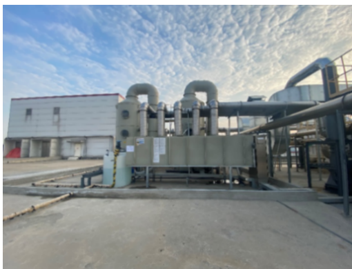
注入电解液工段废气收集现场图
