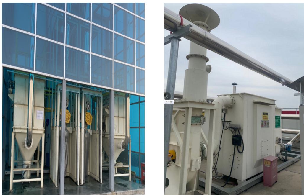
图 4-9 阴、阳极开槽工段/焊接工段含尘气体处置现场图（过滤式集尘器处置）
