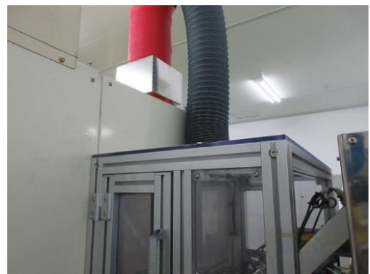
排气工段废气收集现场图
