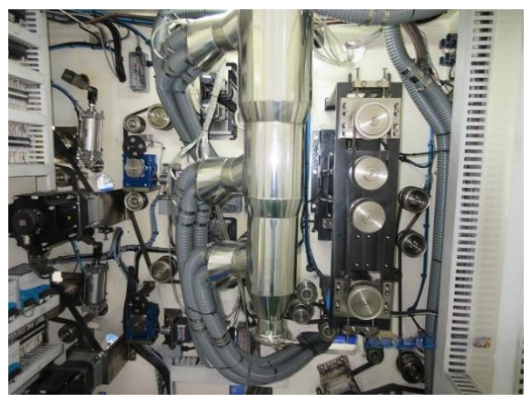
开槽工段废气收集现场图
