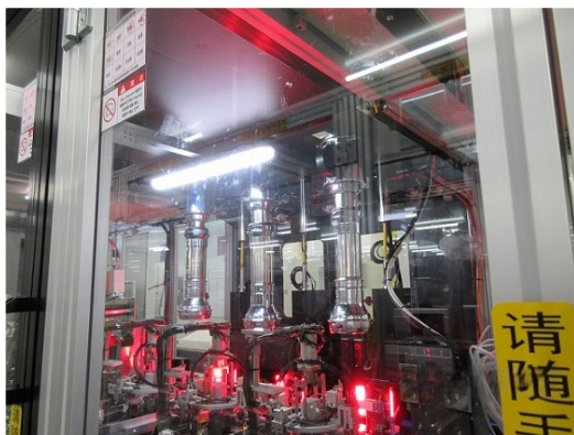
焊接工段废气收集现场图
