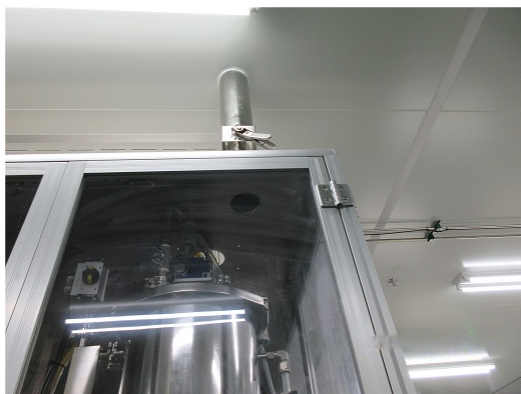
注入电解液工段废气收集现场图
