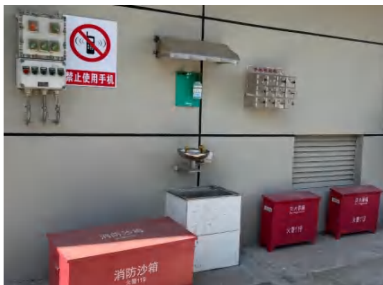
图 2-2 危险品仓库现场照片①
