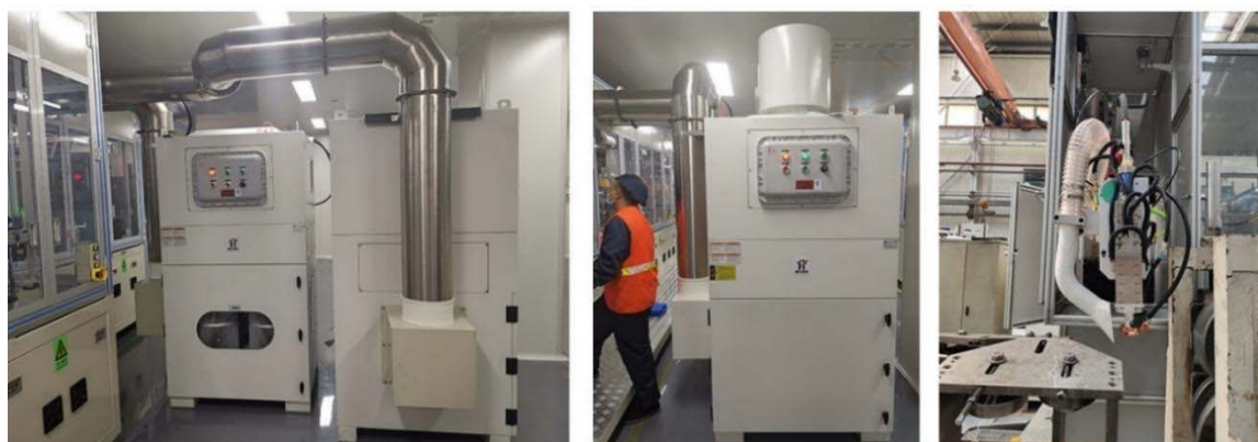
图4-3 除尘机应用现场图
