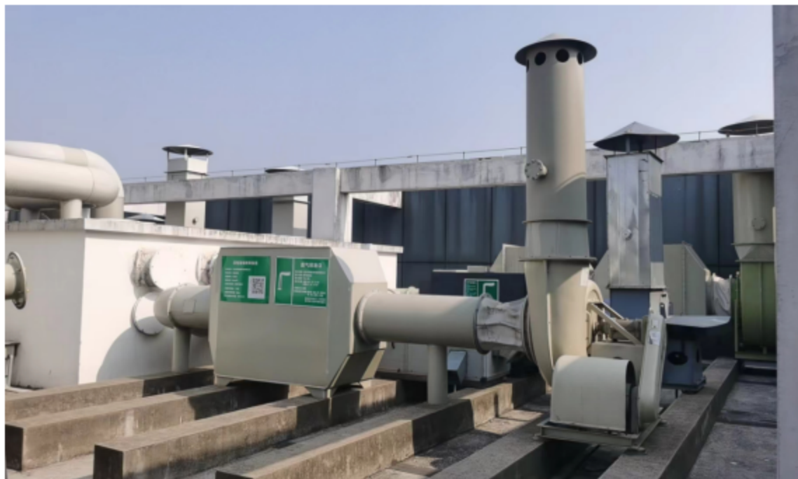
图 2-5 现有项目废气处理设施
