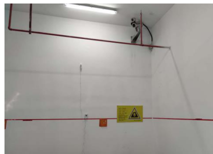
危废库内部监控
