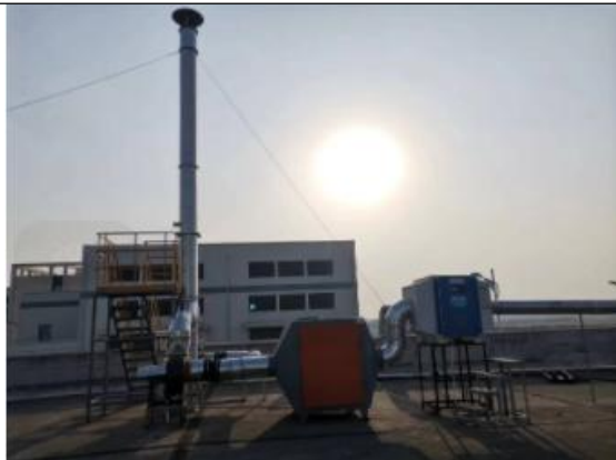
二级活性炭+FQ-9 排气筒
