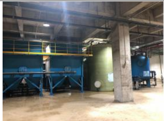
综合废水处理系统
