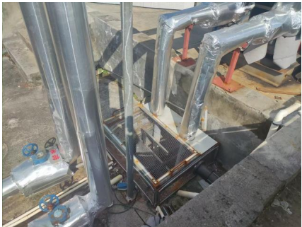
污水排放口阀门
