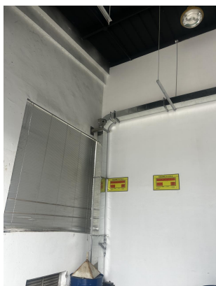
危废仓库内部视频监控设备
