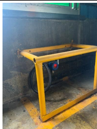
危废仓库内部可燃气体报警设备
