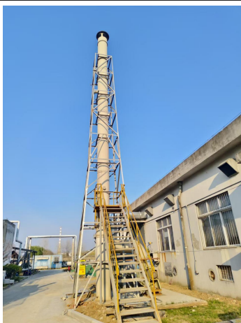
危废仓库配套的废气治理设施
