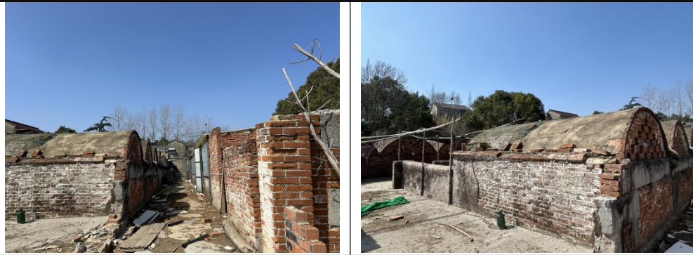
开关站现状废弃养猪棚
