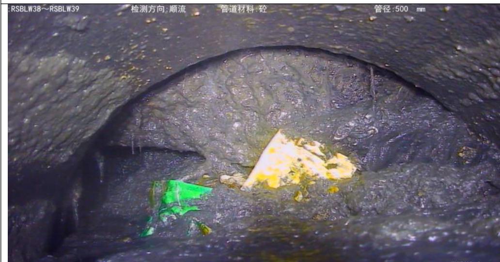
润寿北路管口沥青堵死照片
